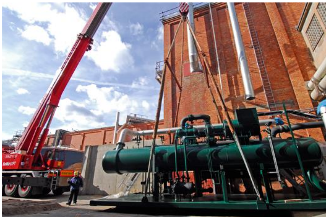
En Opcon Powerbox levereras till Munksjö Aspa Bruk
